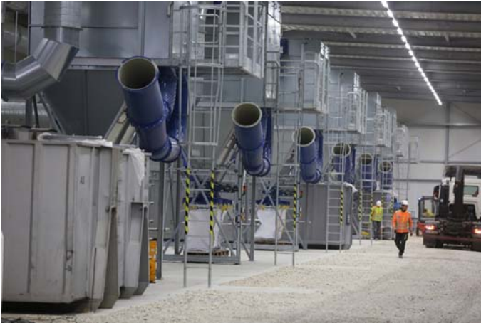
Die Installation der Abluftreinigungsanlage im Baufeld Nord verläuft planmäßig; Quelle: Pressefoto Roche
