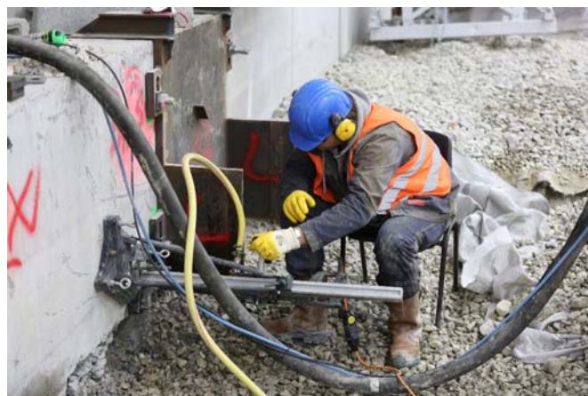
Ein Mitarbeiter führt Bohrungen an der Kopfplatte aus für die Verankerung der Steifen im Baufeld Süd; Quelle: Pressefoto Roche
