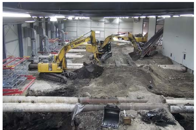
Zwei Bagger führen das belastete Erdmaterial einem Transportband zu. Quelle: Pressefoto Roche
