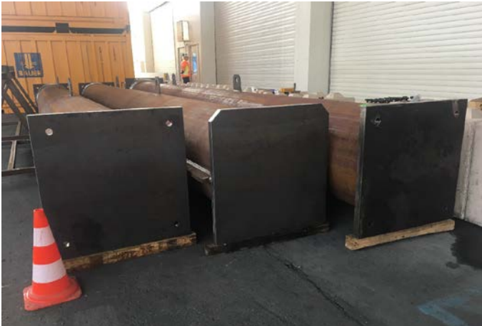
Eine aus drei Teilen bestehende neue Steife liegt bereit für die Einschleusung in die Einhausung. Quelle: Pressefoto Roche
