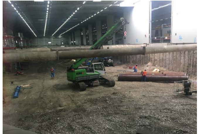
Eine schadhafte Steife wird in der Einhausung mit einer neuen Steife ersetzt. Quelle: Pressefoto Roche
