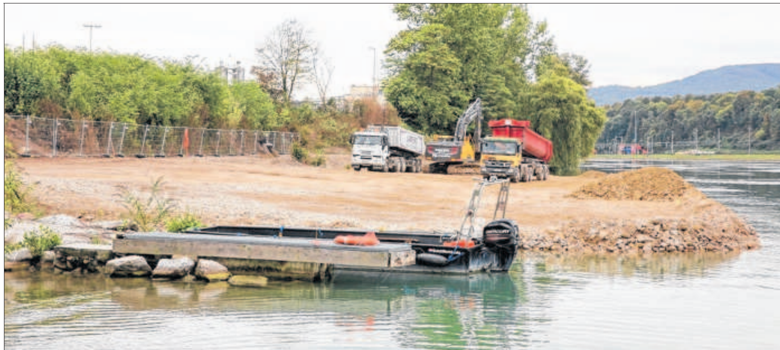
Dieser Tage wurde der Schotter für die Schüttung des Schiffsanlegers am Rheinufer bei der Keßlergrube ausgebracht. Foto: Roche/zVg
