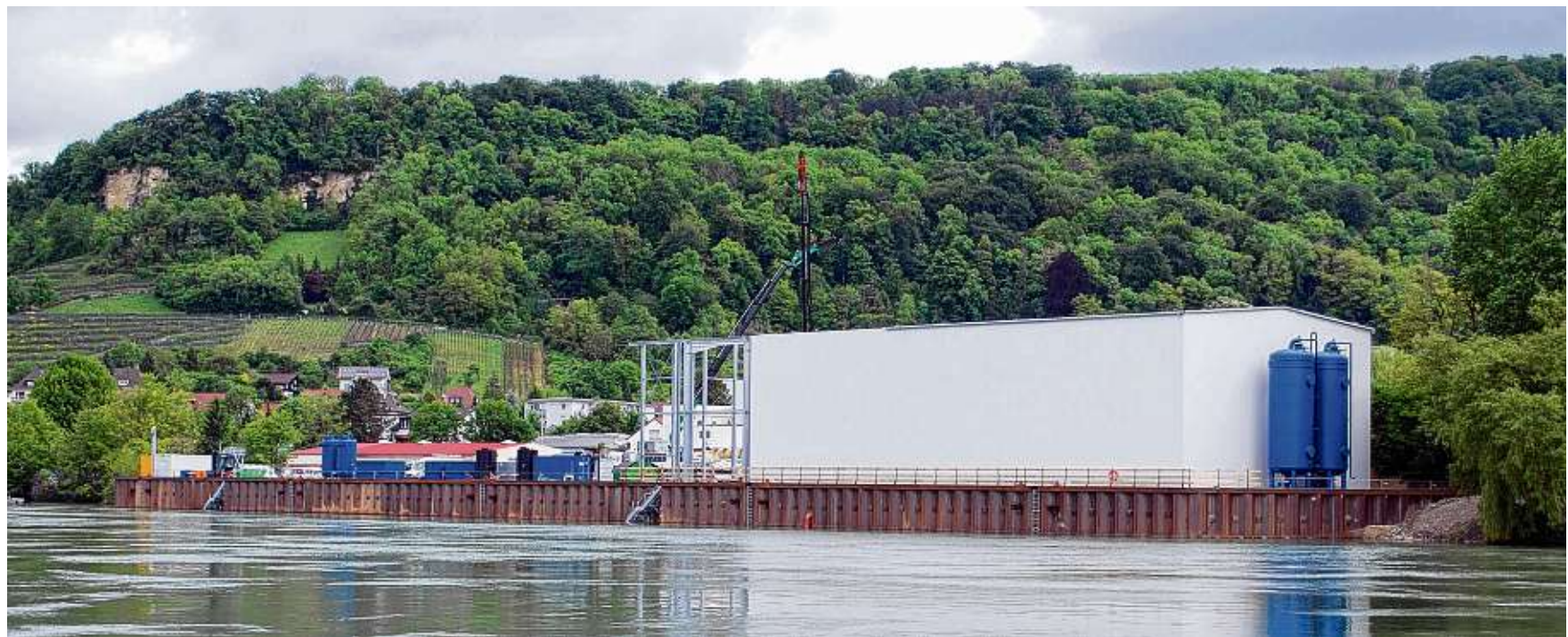
Nach acht Monaten Bauzeit hat Roche eine temporäre Schiffsanlegestelle an der Kesslergrube fertiggestellt. Belastetes und frisches Erdreich sollen hier ab- und antransportiert werden.
