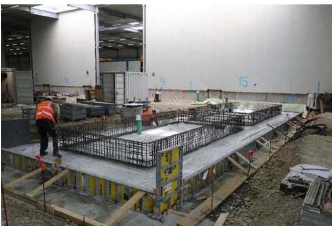
Im Baufeld Süd und innerhalb der Logistikhalle finden Bewehrungs- und Schalungsarbeiten für die drei Schleusensysteme statt. Quelle: Pressefoto Roche.
