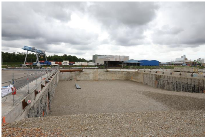
Ein Teilbereich des mittleren Baufelds wird zeitnah vollständig mit frischem Erdreich aufgefüllt. Quelle: Pressefoto Roche.
