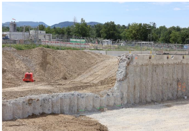
Die Trennpfahlwände zwischen den Bauabschnitten werden um bis zu sechs Meter gekürzt, um eine Folgebebauung zu ermöglichen. Quelle: Pressefoto Roche.
