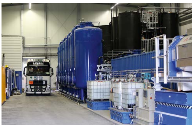
Abbildung 4: Bau und Inbetriebnahme einer Grundwasserreinigungsanlage bis 20 l/s zur Abstromsicherung und Trockenlegung des Aushubbereichs, Direkteinleitung in den Rhein.
