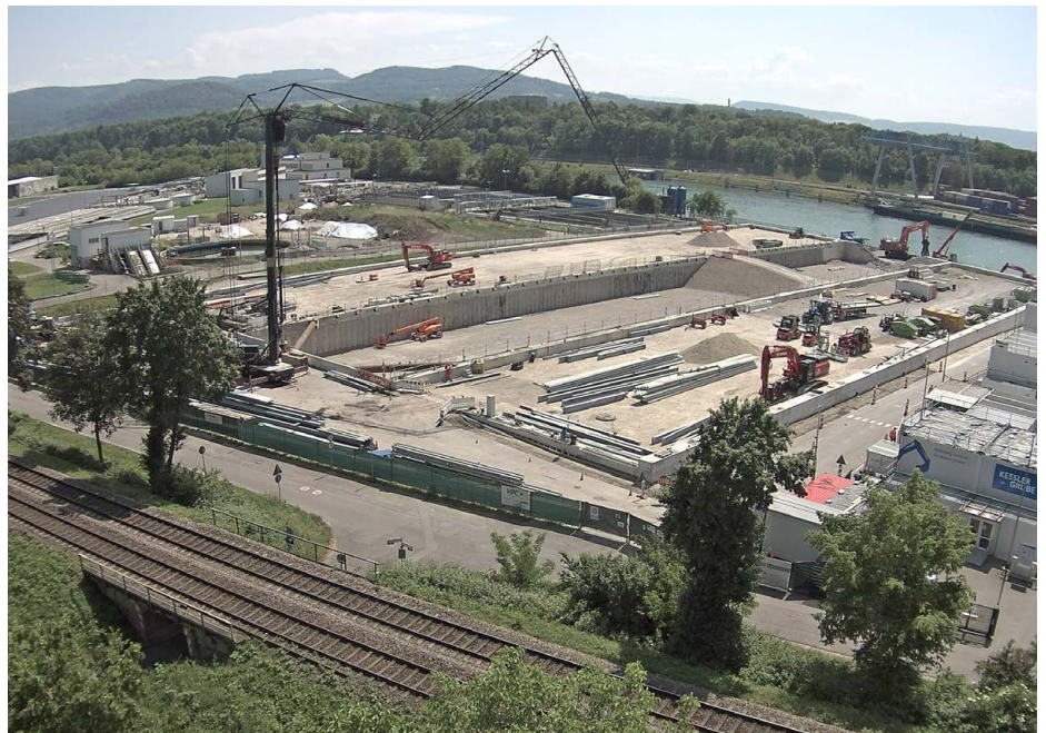
Die Rückbauarbeiten an der Einhausung sind beendet: Am 1. Juni 2023 wurden die letzten Tragwerkselemente der Einhausung demontiert und abgebaut; Quelle: Pressefoto Roche.
