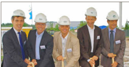
Die Verantwortlichen beim ersten Spatenstich für die Sanierung der Kesslergrube, Bürgermeister Jörg Lutz (von links); Dr. Hagen Pfundtner, Vorstand von Roche Pharma Deutschland; Dr. Richard Hürzeler, Gesamtleiter der Sanierung; Thomas Osberghaus, Gesamtleiter der Planers und Hans-Georg Meier von der beauftragten Straßenbaufirma. Foto: rr
